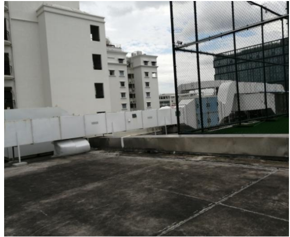
项目废气处理设施 2
