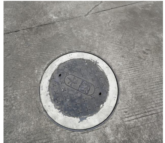
项目厂房外污水井盖
