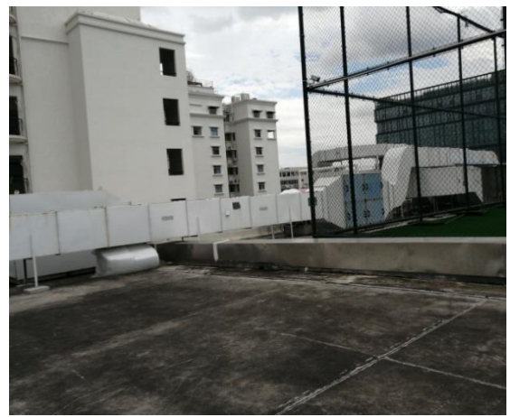
项目废气处理设施 2
