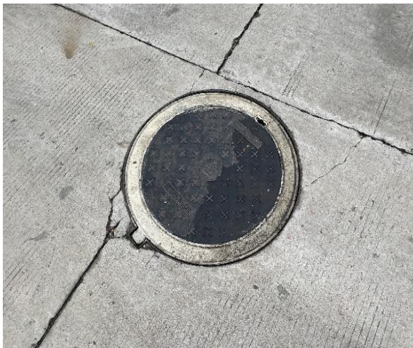
项目厂房外雨水井盖
