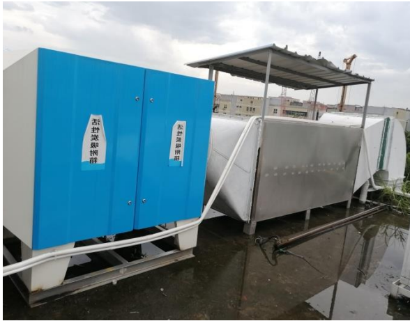
项目废气处理设施 1
