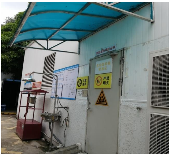
项目危废暂存间
